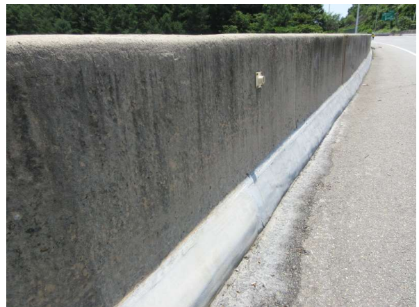
방호벽 델리네이트 파손 S2
