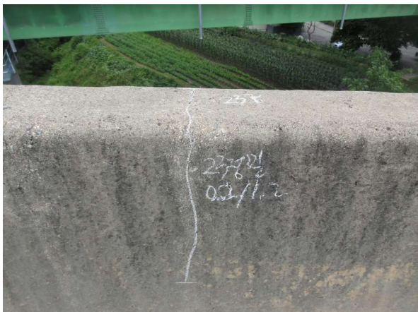
방호벽 균열 (0.3mm미만) S1
