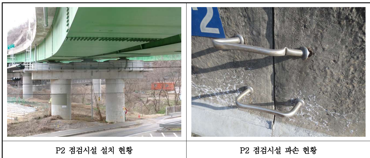
【사진 1.7.3】 점검시설 설치현황
