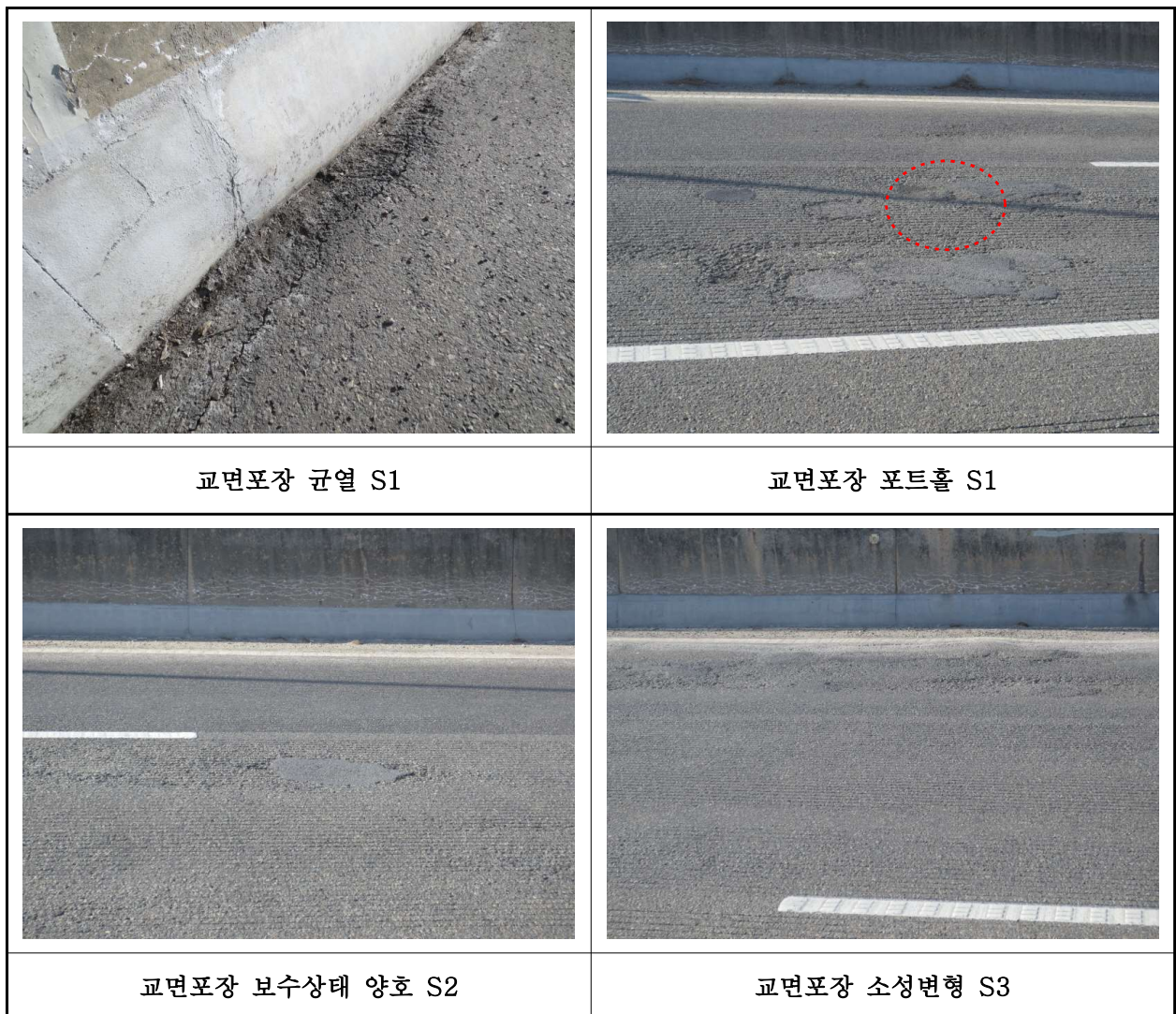
【사진 1.3.18】 교면포장 손상현황
