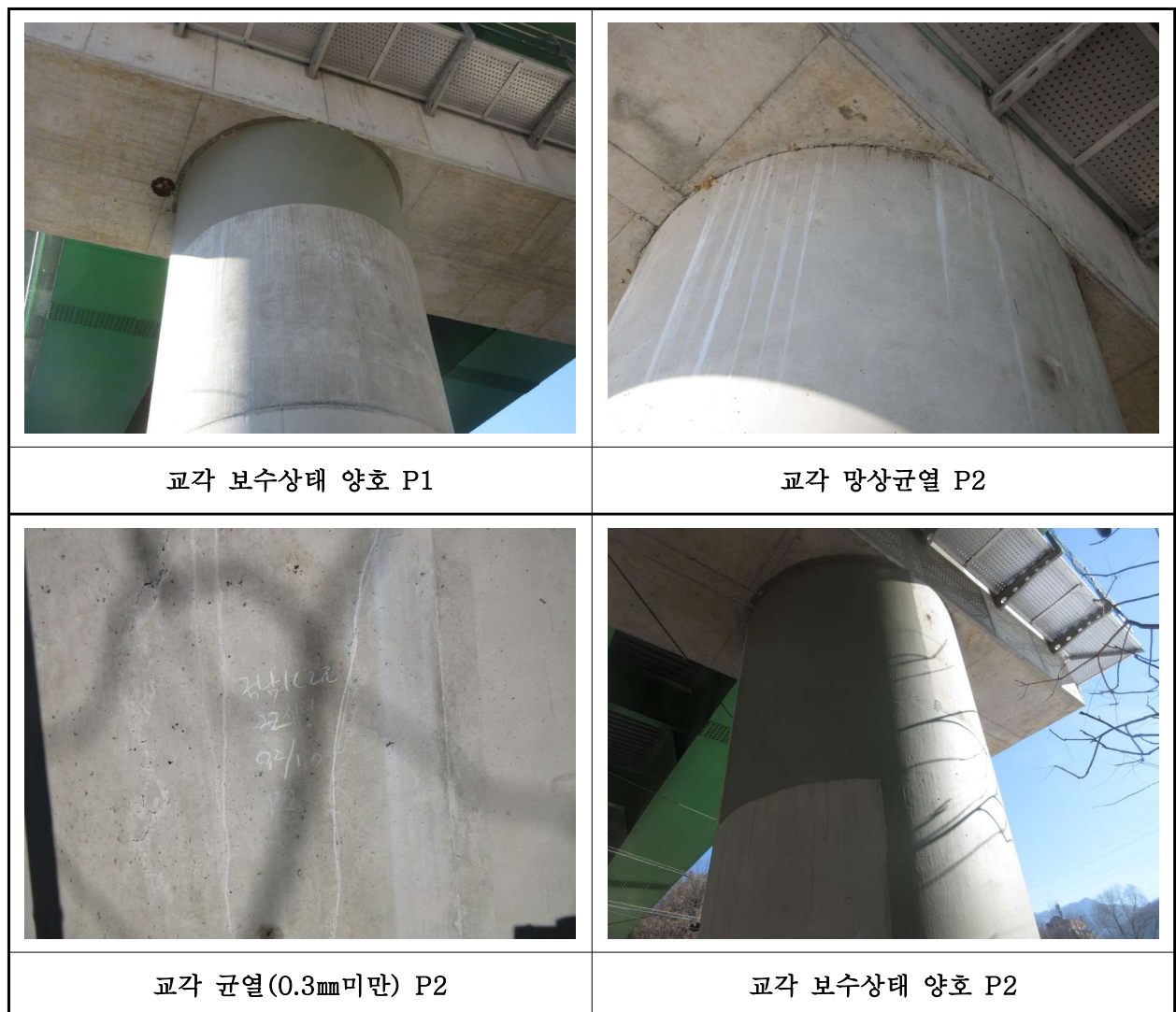
【사진 1.3.12】 교각 손상현황
